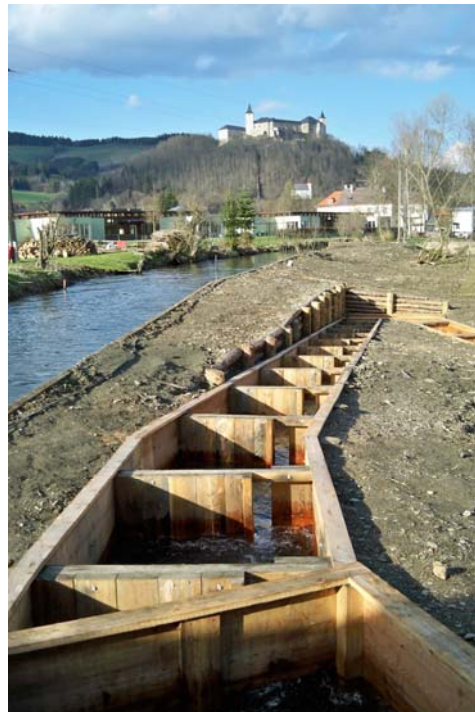
Abb.6: Fischaufstiegshilfe als „vertical slot“ in Lärchenholzbauweise beim KW Kogler in Straßburg
